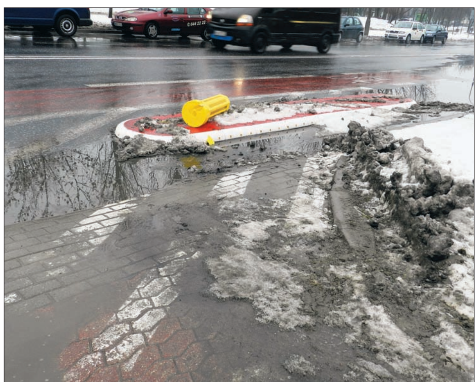
Szkody przy wjeździe do Leclerka, na szczęście już naprawione
